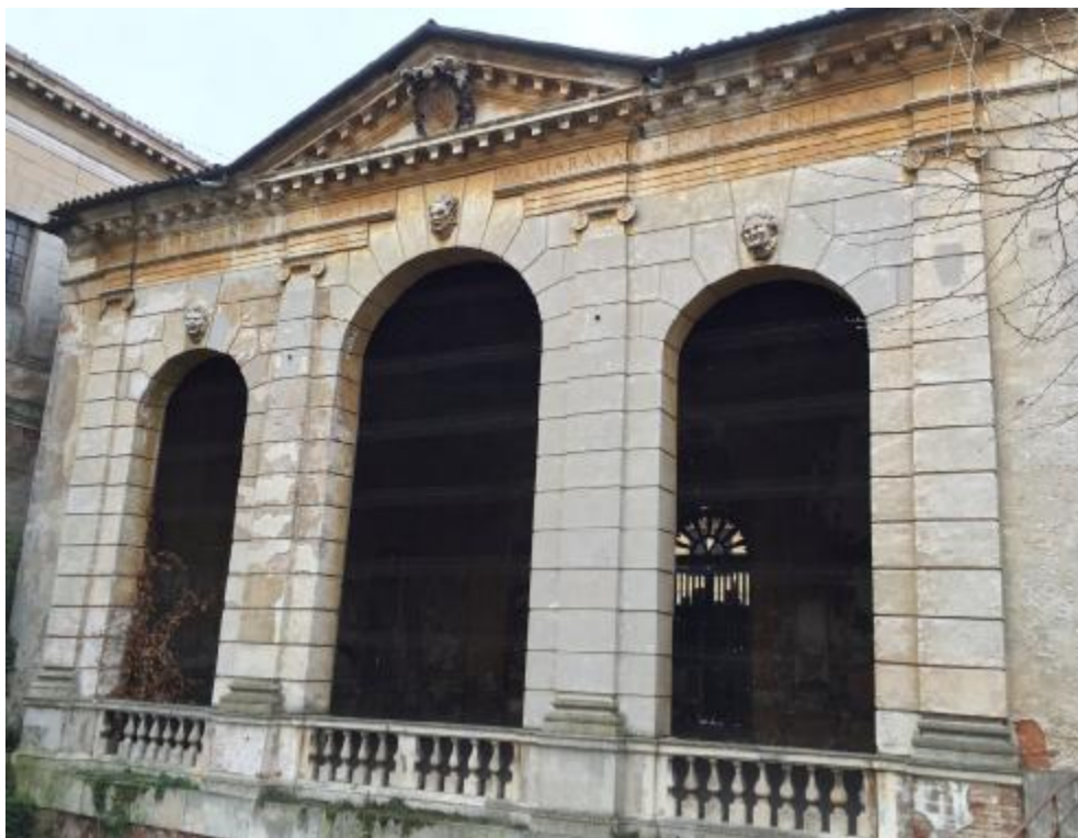
La loggia Longhena al Giardino Salvi risale al 1649 ed è da tempo in condizioni di degrado
